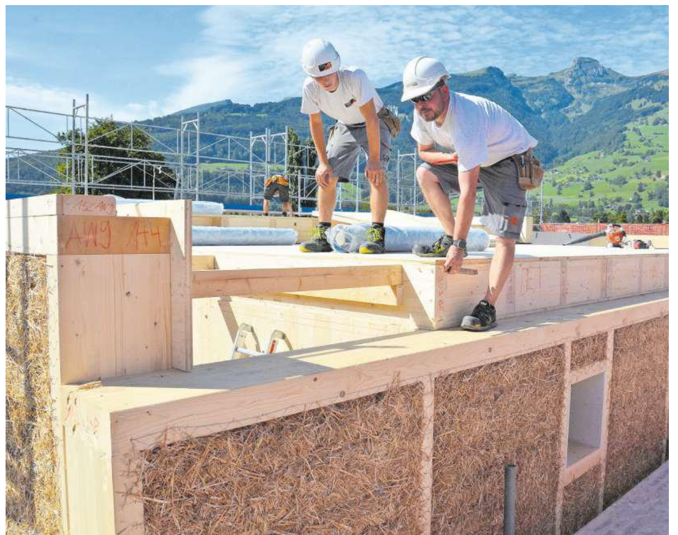
Die Mitarbeiter der A. Gantenbein Holzbau AG, Elias Heeb (links) und Markus Eggenberger, besprechen die Details beim Aufrichten der Strohelemente für den Neubau der Stiftung Spielraum-Lebensraum. Bild: Katharina Rutz
